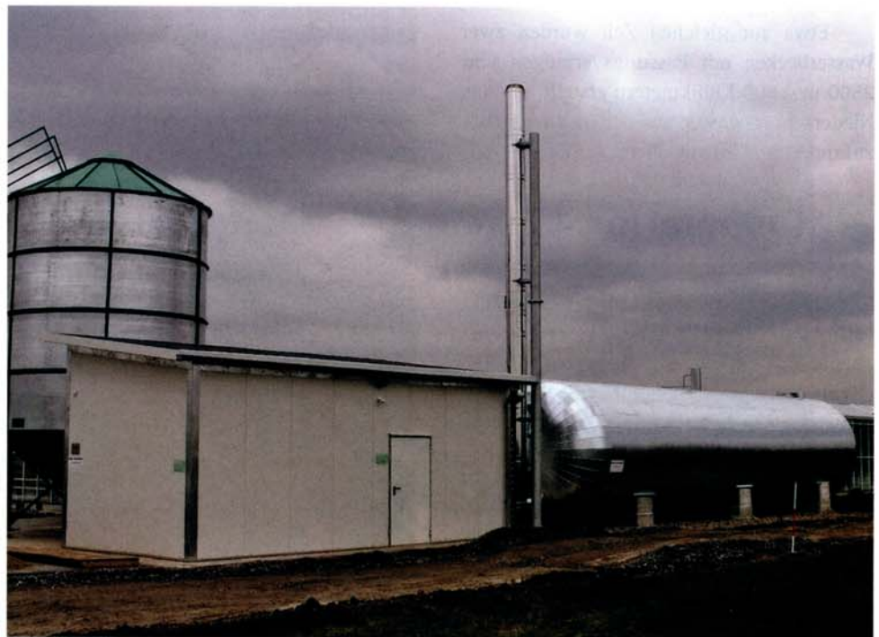
Zur neuen Pellet-Heizung im Betrieb Senta Fleischle gehören unter anderem das Kesselhaus, der Pelletspeicher (links) und der Pufferspeicher für das erhitze Wasser (rechts)
