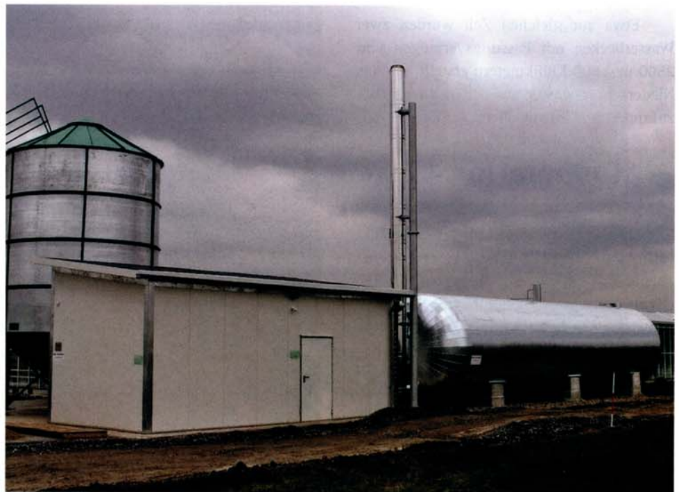
Zur neuen Pellet-Heizung im Betrieb Senta Fleischle gehören unter anderem das Kesselhaus, der Pelletspeicher (links) und der Pufferspeicher für das erhitze Wasser (rechts)
