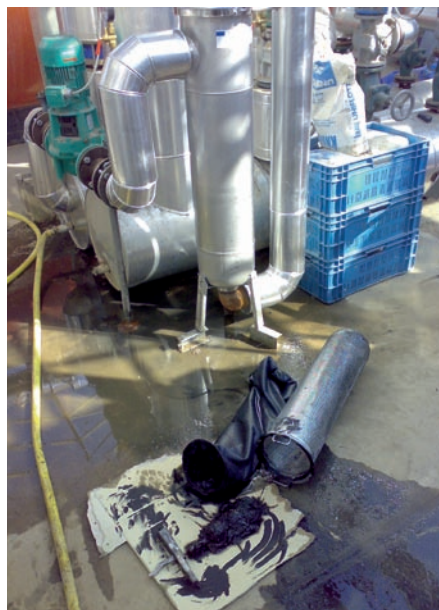
Weiterentwickelte Teilstromfilter verhindern solche Ablagerungen in Wärmetauschern oder Kesseln Werkaufnahme: Van Bebber
