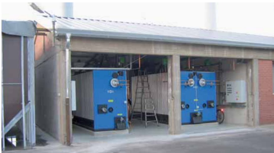
Kohle soll über 80 Prozent der Wärme liefern: Bestandteile der Anlage bei Kientzler sind zwei Füllschachtkessel mit 2270 sowie 910 kW, die in ein bestehendes Gebäude integriert wurden
