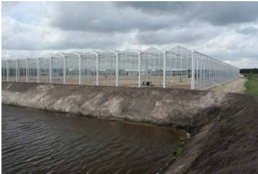
Stabile Konstruktion auf sandigem Unterboden: Wegen des windigen ostfriesischen Klimas waren größere Fundamente und zusätzliche Verstrebungen notwendig
