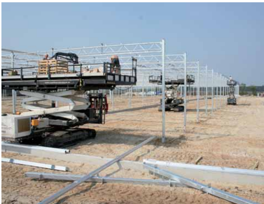
Bauarbeiten schreiten planmäßig voran: Jan Klusmann hat sich bei seinem Neubau für einen Venoblock von Maurice + Ammerlaan mit fünf Meter Stehwandhöhe entschieden
