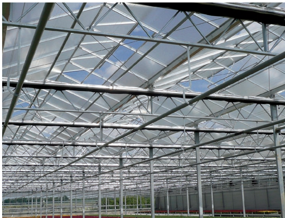
Motiv vom Neubau im Frühjahr 2008. Abwechselnd jeweils vier Scheiben bilden eine Lüftungsöffnung. Auch wurde ein spezieller Glastyp gewählt Werkaufnahmen: Lang (2)
