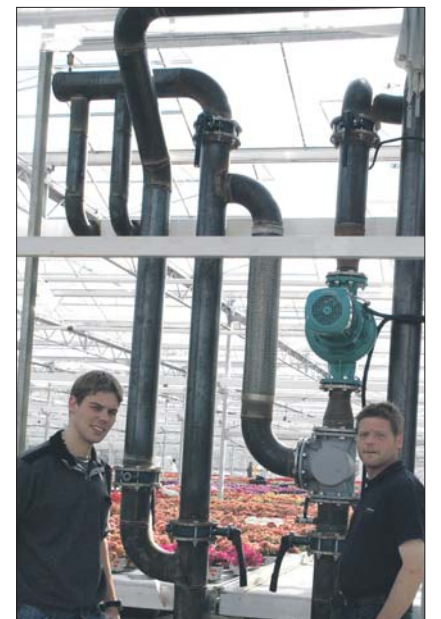
Zugunsten der Flächeneffizienz in die Stehwand integrierte Pumpenstation. Thomas Paes (li.), Inhaber van Bebbler, und Wilhelm Westhoff. Fotos: Werner Oschek
